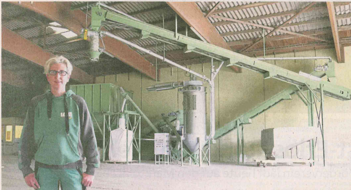
Korinna Giere, Mitarbeiterin der Vereinigten Saatzuchten Ebstorf, steht vor der großen Maschine im neuen Umschlagslager in Wrestedt. Mithilfe dieser Anlage werden die Lastwagen mit Holzpellets befüllt.
